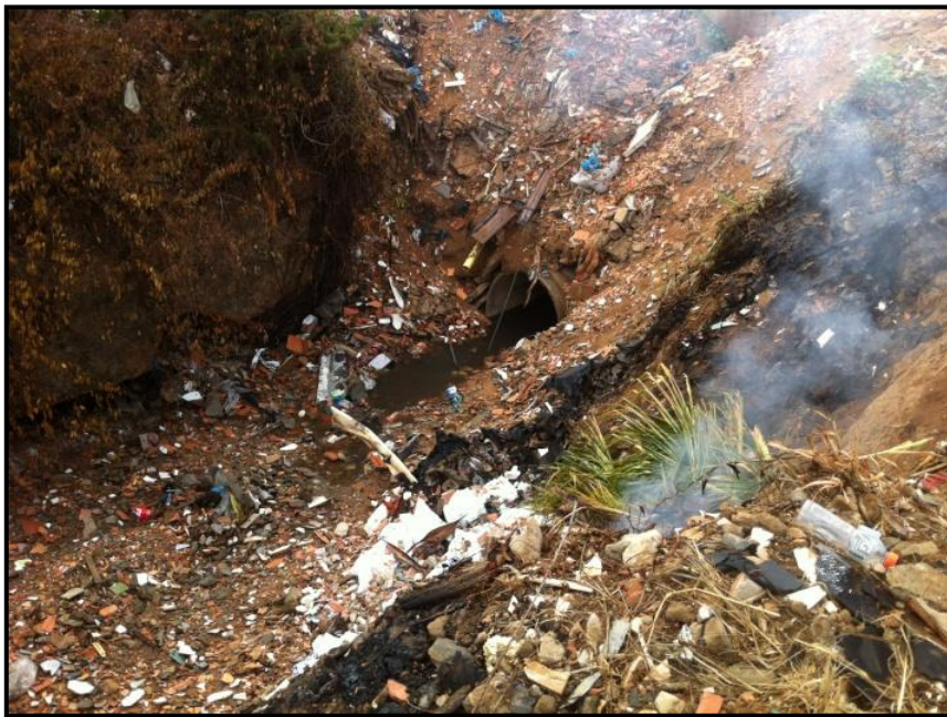
Anexo 1.4. Unión entre colector de aguas residuales y el cauce natural Fuente: Propia.
