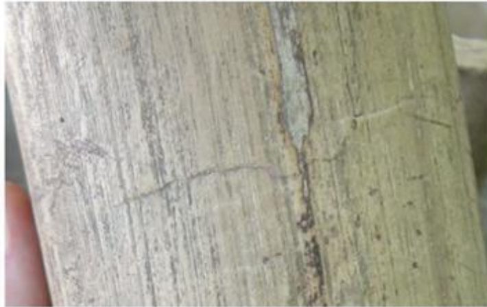
Figura 8. Falla por pandeo de las fibras en dirección interna (Kosler & Carballo, 2018)
